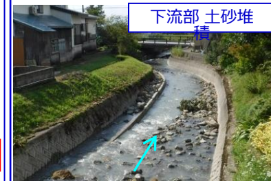
上流の流出土砂が下流に堆積
