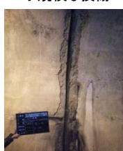
小規模な損傷
