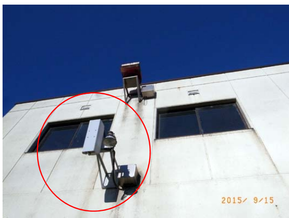
水門を操作するための監視カメラが機能不全になっている(小牧川水門)
