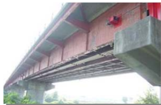
塗膜劣化による錆→放置すると腐食
