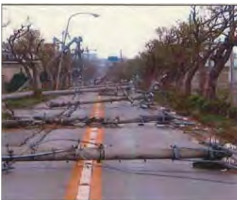
台風による道路の被災
