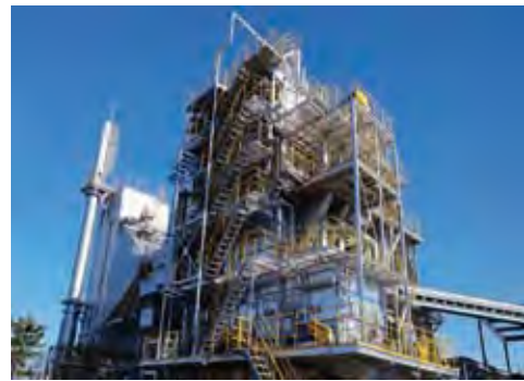
庄内地域における木質バイオマス発電所
