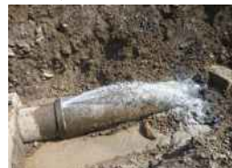
パイプラインからの漏水
