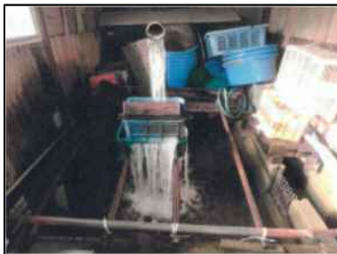
井戸ポンプの老朽化
