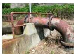
老朽化した水利施設
