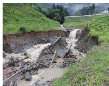
豪雨により被災した水路 (白鷹町H26.7.10)
