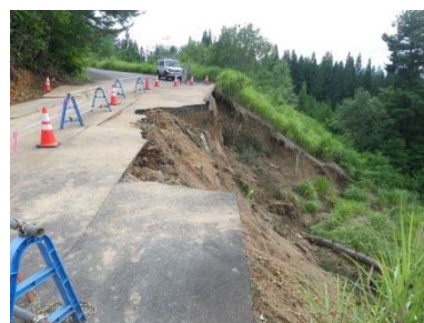
豪雨により被災した林道 (南陽市H26.7.10)
