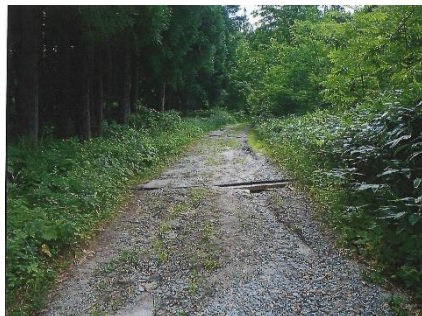
（林道田沢線修繕前の状況）
