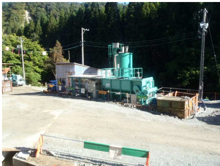
濁水処理設備
