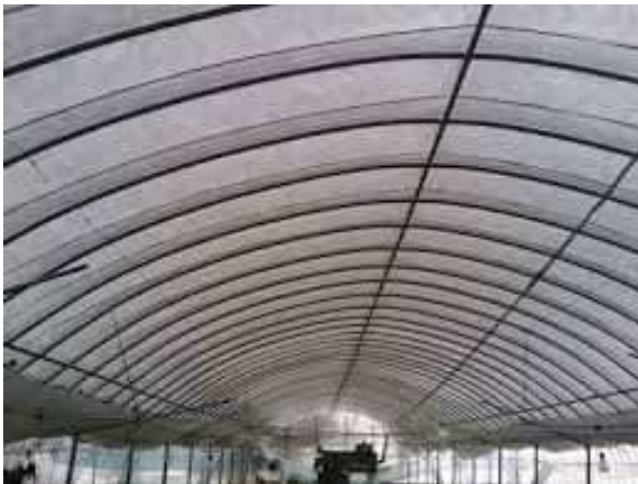
写真 32 屋根面に着雪し、融雪が必要となっているハウスの状況
