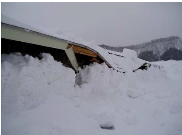
写真 37 畜舎軒先の損壊状況
