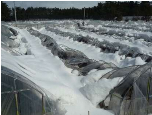
写真45 倒壊したハウスの状況 (外側)
