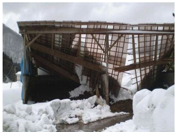
写真 38 堆肥舎屋根の損壊状況
