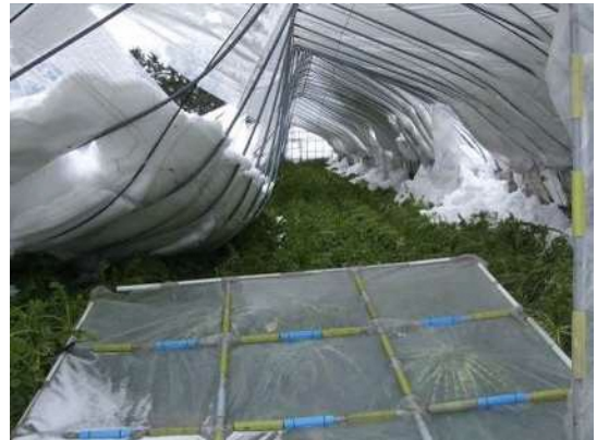
写真46 倒壊したハウスの状況 (内側)
