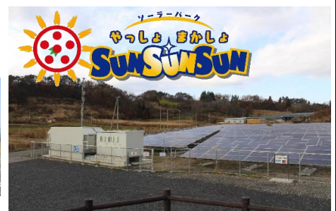
太陽光発電事業施設
