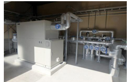
日本環境科学(株)ヒートポンプ室
