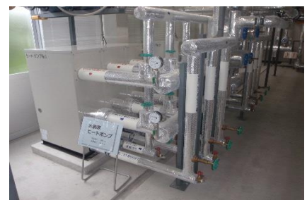
本社ヒートポンプ室
