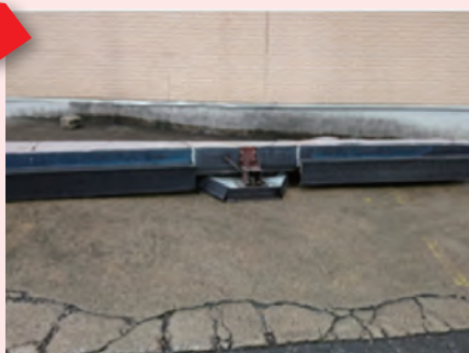
落下した欄間看板
