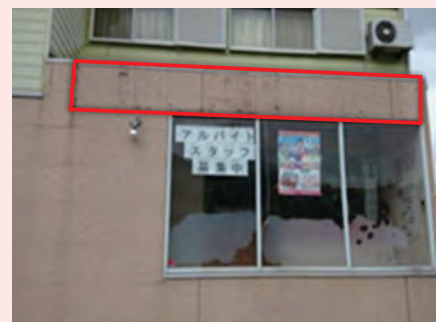
落下した後の壁面
