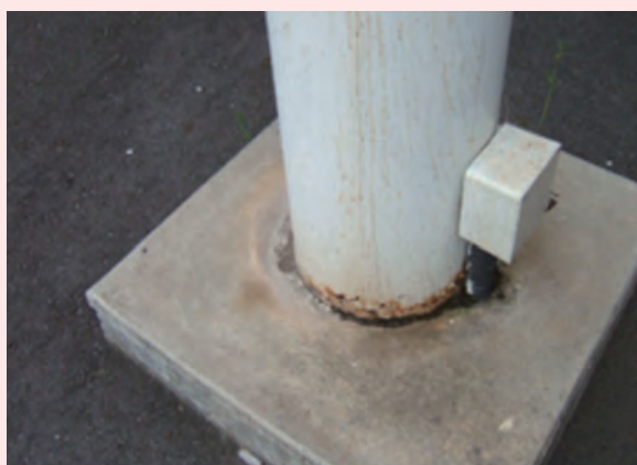
ポールの根元にサビが発生
