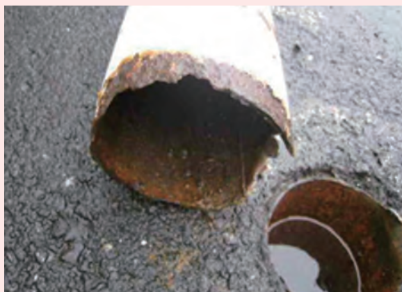
ポールの根腐れによる倒壊
