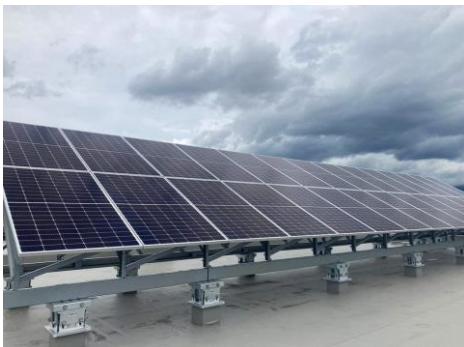
太陽光発電システム
