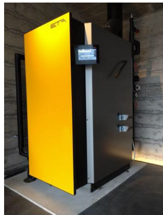
バイオマスボイラー
