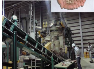
バイオマス燃料加工工場
