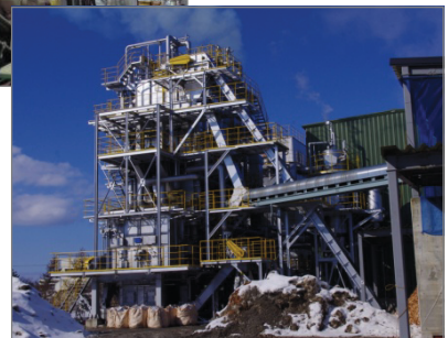
バイオマス発電施設
