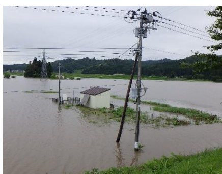
写真 2-2 横山第1マンホールポンプ場 受電設備浸水状況
