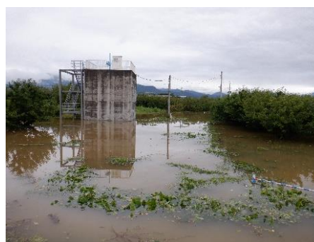
写真 2-3 大久保マンホールポンプ場 受電設備浸水状況
