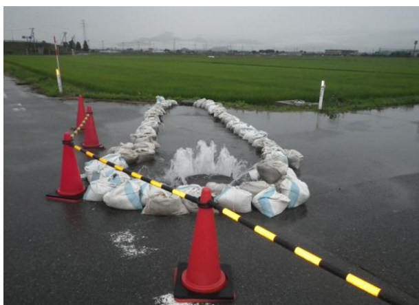
写真 2-1 マンホールからの溢水状況（天童幹線）
