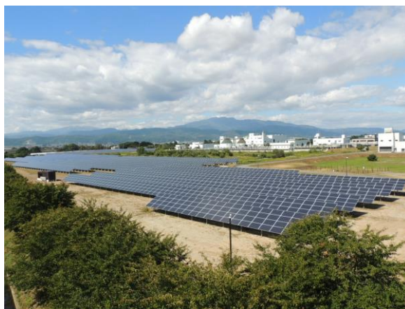
写真 2-6 山形浄化センター太陽光発電施設
