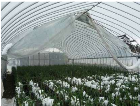
写真 47 被覆資材が破損し、作物が雪を被った状況
