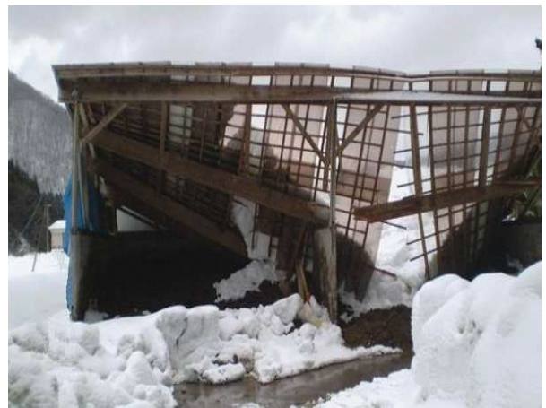
写真 38 堆肥舎屋根の損壊状況
