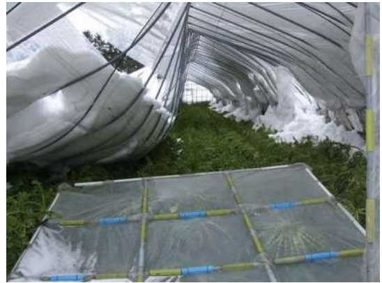
写真46 倒壊したハウスの状況 (内側)
