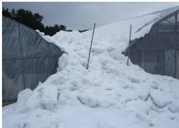
写真36 積雪がハウスの肩まで達し、 早急に除雪が必要な状況
