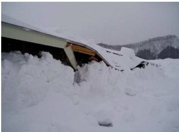
写真 37 畜舎軒先の損壊状況
