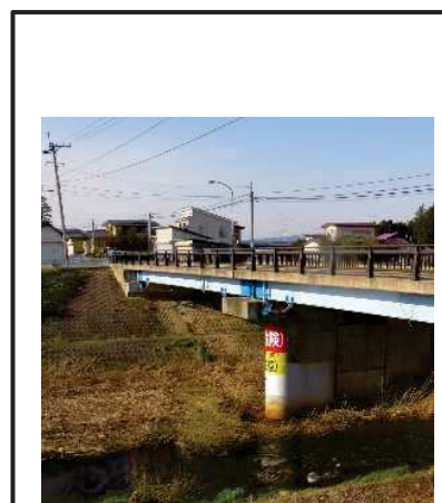
量水標設置状況
