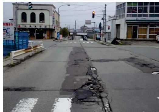
無散水消雪（放熱管）の破損状況
