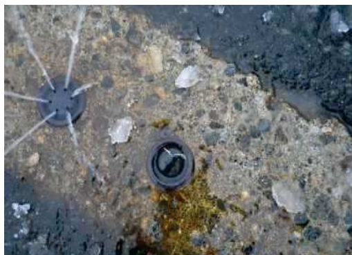
消雪パイプの破損状況
