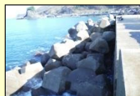
消波ブロックの沈下
