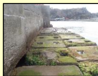
防波堤基礎洗掘
