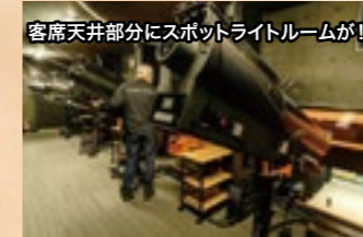
客席天井部分にスポットライトルームが! 客席最奥の上部には4台の大型スポットライトが設置され、30m先の舞台を照らします。
