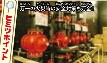
万一の火災時の安全対策も万全! 舞台専用の消火用スプリンクラーは、210t(25mプールの約半分)もの水を放水できる容量があります。
