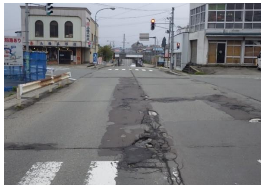
無散水消雪（放熱管）の破損状況
