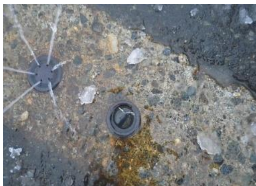
消雪パイプの破損状況
