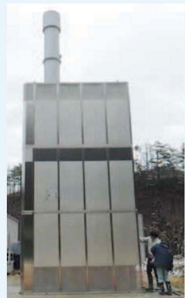
廃棄物焼却炉
