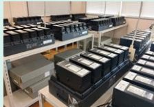
バッテリー保管・充電施設
