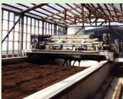
メタンの排出抑制、 良質な堆肥生産に資する 堆肥化処理施設
