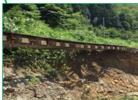
盛土流出 (伊佐領～羽前沼沢間)
