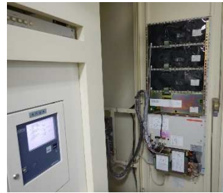
中央病院 照明制御盤 (現行)
