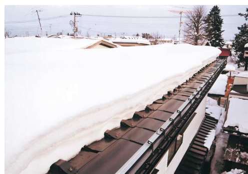
【克雪化の例】 屋根に融雪設備を設置
