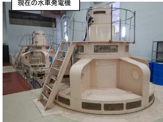
現在の水車発電機
