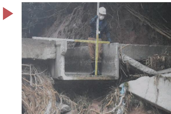
↑ 水路の破損状況を調査する土地改良区職員（小国町）
