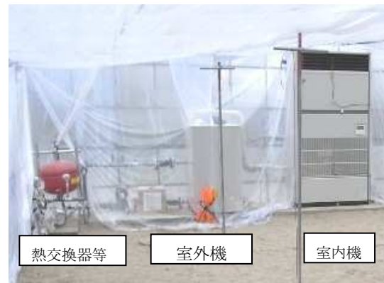
図2 ヒートポンプの設置状況
