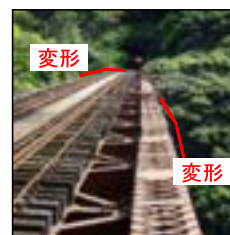
第一白川橋りょうの変形
