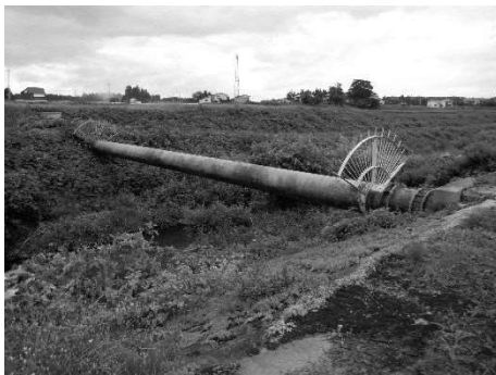
老朽化した水管橋
