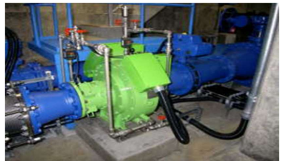
【平田浄水場 小水力発電設備】
