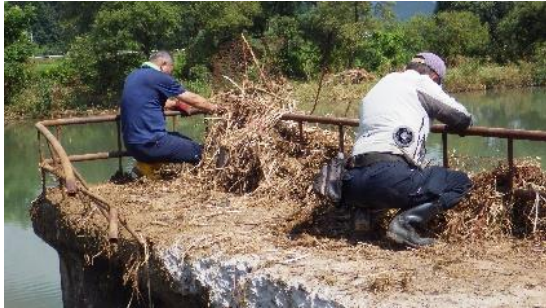
太鼓胴頭首工の応急復旧（真室川町大沢）
