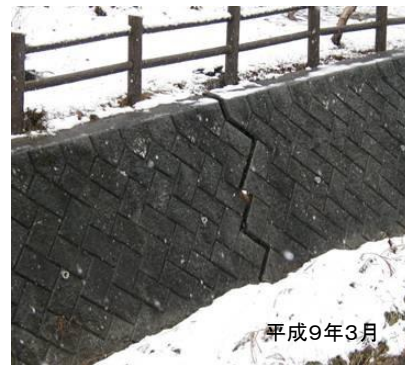
地すべりにより河川護岸が破損
