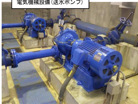
電気機械設備(送水ポンプ)
