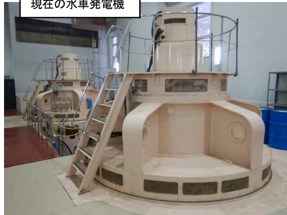
現在の水車発電機
