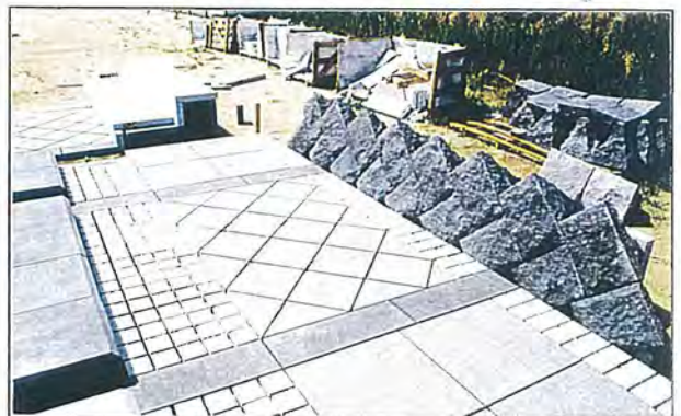
石材の現場合わせの様子。各個の大きさ、表面の加工法、色味、素材の持つ味わい等を十分に考慮しながら、現場合わせを行い、使用する石材を確認する。
