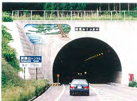
面壁に地域の特性を表すレリーフを設置することは、トンネルの機能に全く無関係で、必然性の感じられない装飾である。
