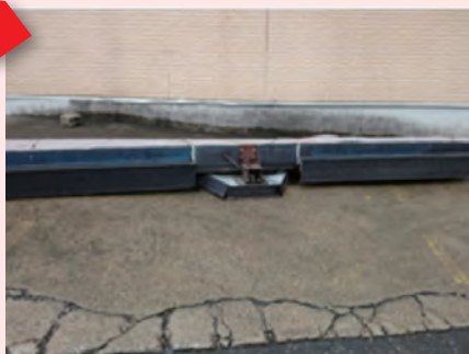
落下した欄間看板
