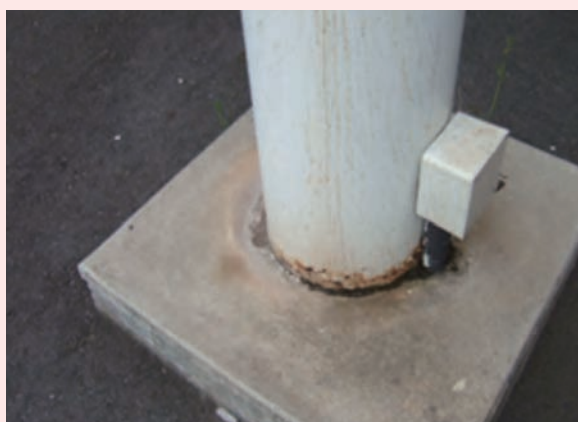
ポールの根元にサビが発生
