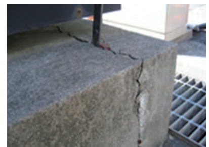
看板基礎のひび割れ
