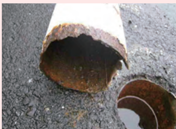
ポールの根腐れによる倒壊
