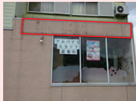
落下した後の壁面
