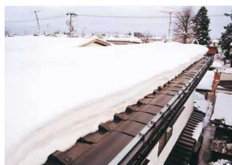
【克雪化の例】 屋根に融雪設備を設置
