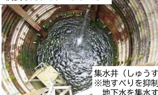
腐食したライナープレート
