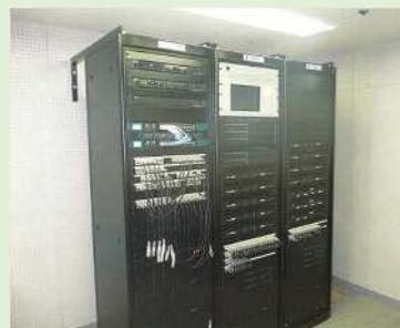
放送設備(R2完了)
