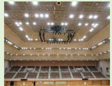
照明設備(R3完了)
