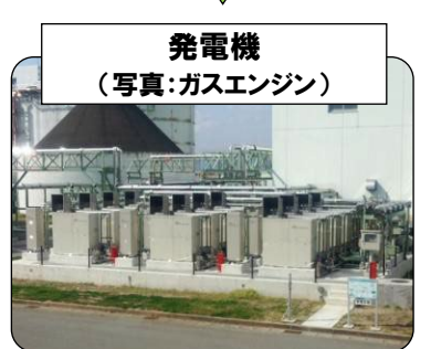
発電機 (写真: ガスエンジン)
