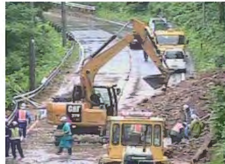
▲国道47号への土砂流入 (最上町H30.8)
