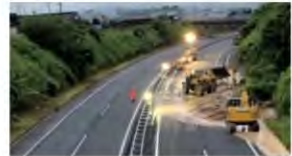
九州道で法面崩落が発生した際、4車線のうち被害のない2車線を活用し、約8時間で一般車両の下り線の通行を確保(約19時間後には一般車両の上下線の交通機能を確保)
