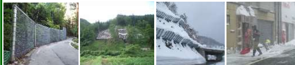
▲防災対策(例) 左:(主)上山七ヶ宿線 (上市市) 落石防護柵 右:(主)余目温海線 (鶴岡市) 法面保護工 ▲冬期間の交通安全対策(例) 左:(国)344号 (真室川町) 雪崩予防柵 右:(一)大石田名木沢線 (大石田町) 流雪溝
