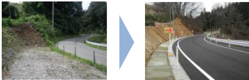
▲地域の実情に応じた道路改良の事例 (主)山形永野線（山形市土坂）の部分的な拡幅
