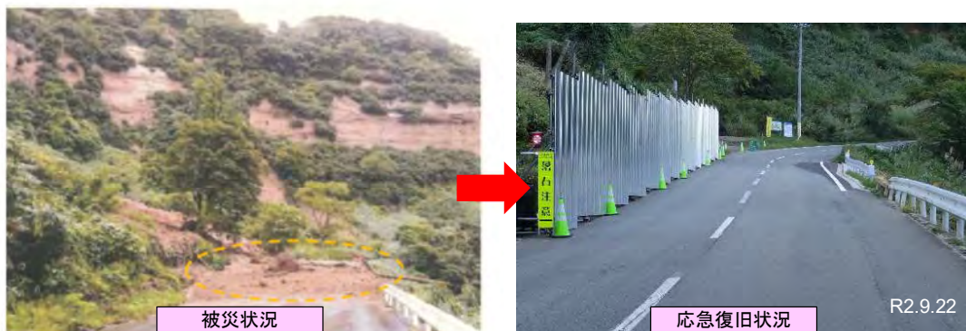
2 (国)458号 (大蔵村南山) 土砂流出
