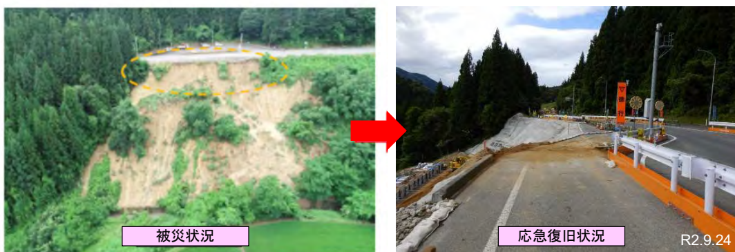
3 (国)348号 (白旗町滝野) 路肩崩落
