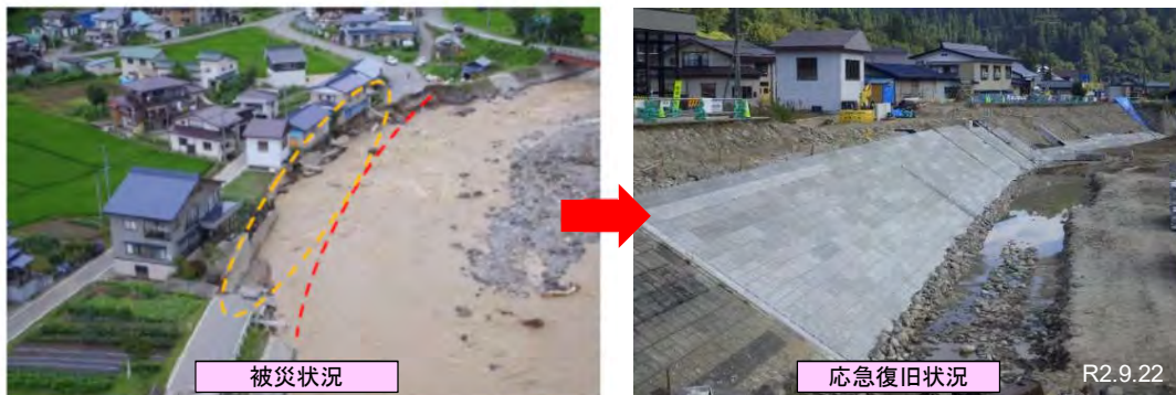
1 (一)片倉塩線 (大蔵村南山) 道路欠損
