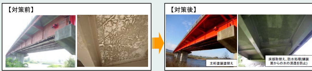
▲予防保全型管理による長寿命化の取組み
