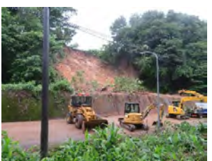
▲国道287号の法面崩壊 (朝日町 R2.7)
