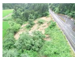
▲国道348号の法面崩壊 (白鷹町R2.7)
