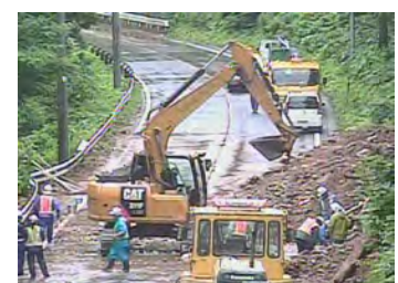
▲国道47号への土砂流入 (最上町H30.8)
