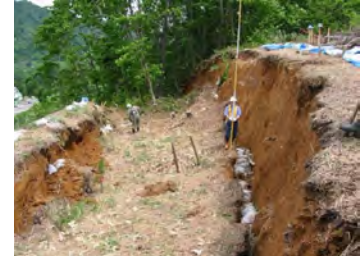
▲国道112号月山道路の地すべり (鶴岡市H16.5発生)
