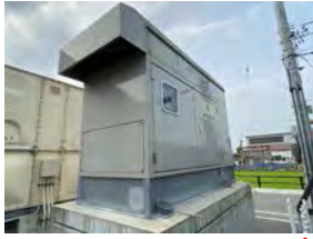
自家発電装置
