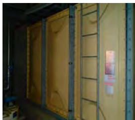
給水施設 ・概ね3日分容量確保 ・非常時に飲料用水として供給
