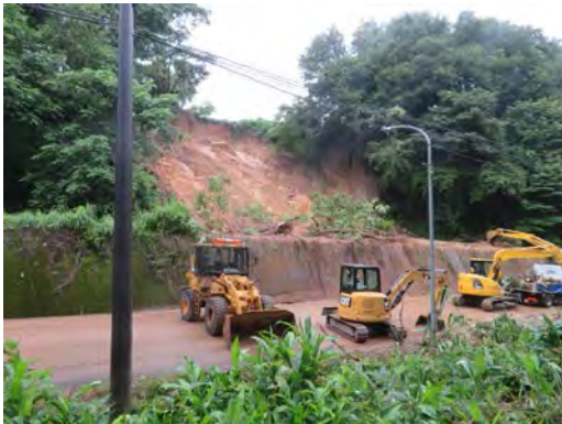
▲国道 287 号の法面崩壊 (朝日町 R2.7)
