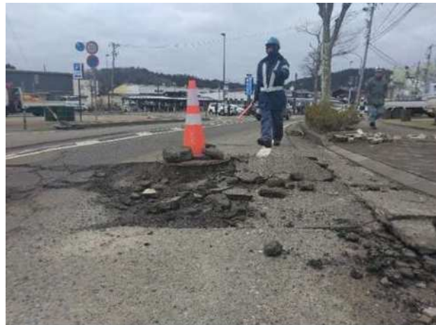
(令和 6 年能登半島地震による下水道マンホール浮上状況)
