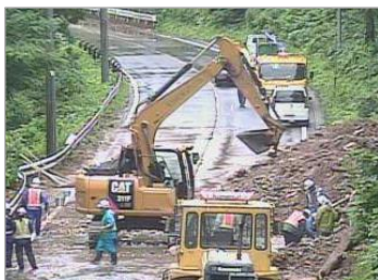
▲国道47号への土砂流入 (最上町 H30.8)
