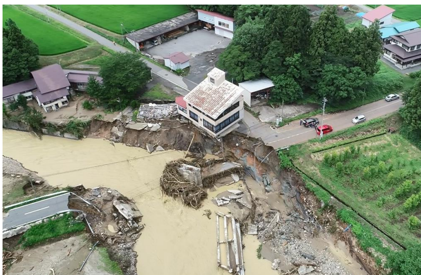
▲(主)米沢飯豊線(飯豊町小白川)大巻橋 令和4年8月の大雨による被災状況
