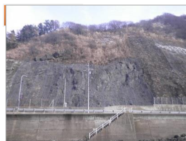
▲ (主) 藤島由良線 (鶴岡市油戸) 落石防護網
