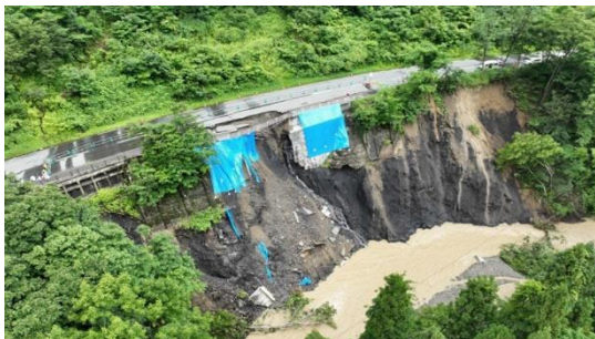
図 3-19 国道 121 号 道路崩落(令和 4 年度)
