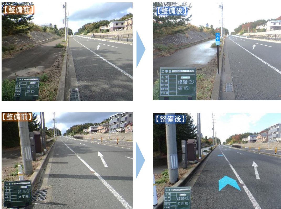
図 3-15 自転車通行帯の整備例(上:自転車案内標識の設置、下:矢羽根マークの表示) (国)112号外 (酒田市浜中～上本町)
