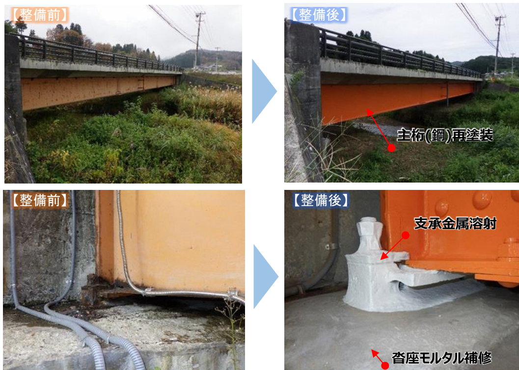
図 3-11 橋梁長寿命化対策例(上:主桁(鋼)の再塗装、下:支承金属溶射、沓座モルタル補修) (主)新庄鮭川戸沢線(戸沢村)濁沢橋
