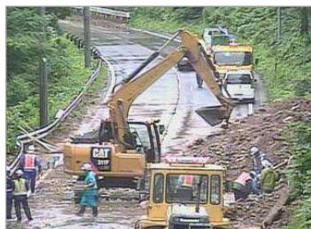
▲国道47号への土砂流入(最上町 H30.8)
