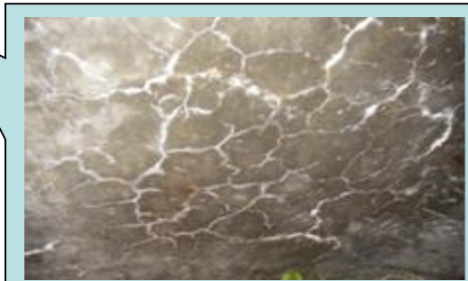
格子状の床版ひびわれ(疲労)
