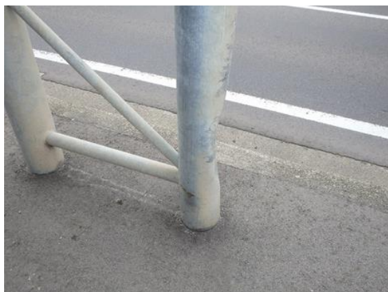
写真 2-1 支柱本体 変形
