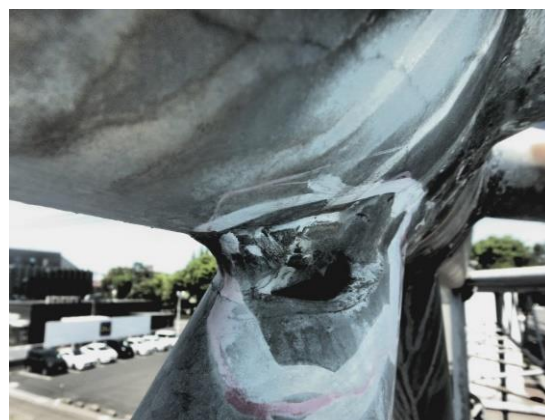
写真 2-4 横梁溶接部 欠損
