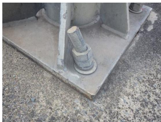
写真 2-6 基礎(アンカーボルト) 変形
