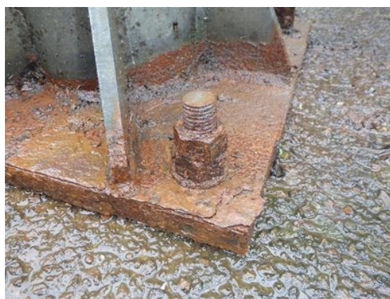
写真 2-2 支柱基部 腐食
