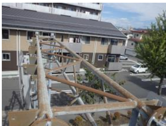
写真 2-3 横梁本体 腐食
